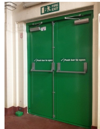
Pic. 4.6.2 Fire door
