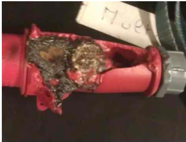
Pic. 7.4.6 Melted connector; geschmolzener Verbinder
